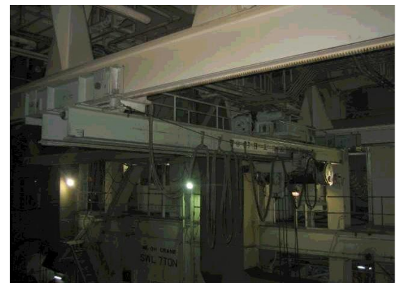
機関室天井クレーン
