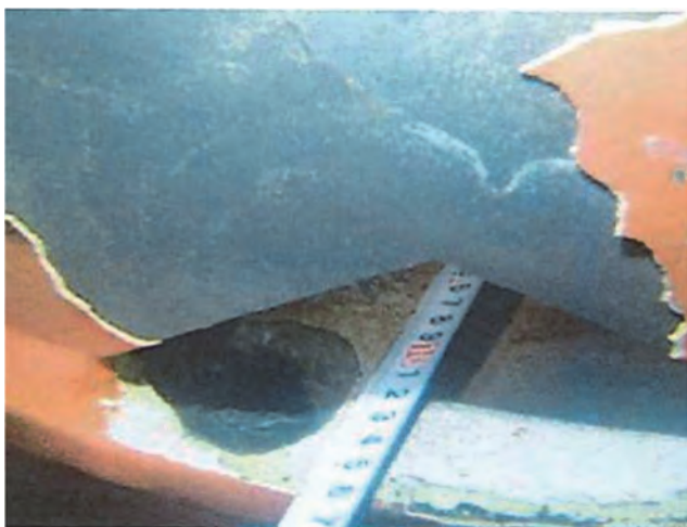
図4 ディスタンスピースとブラフボディとの溶接部近傍の腐食
