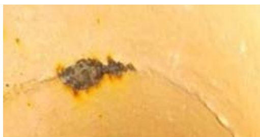
写真3 突合せ溶接部近傍の塗装の剥離
