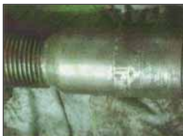
図 3.2.4 No.8 ボルト軸部の段差
