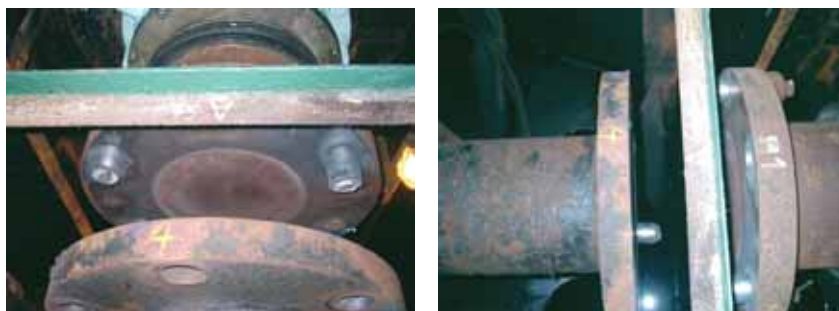
図 3.4.1 ボルトの破断状況
